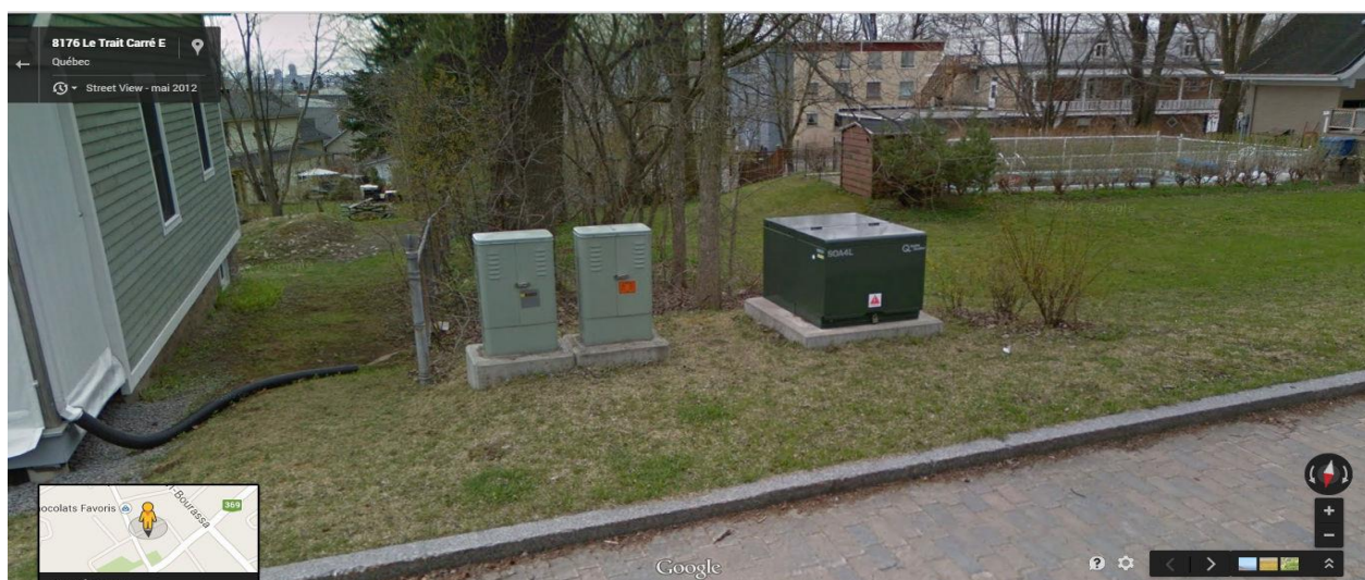
Vue des infrastructures électriques en bordure de la rue du Trait-Carré Nord-Est
