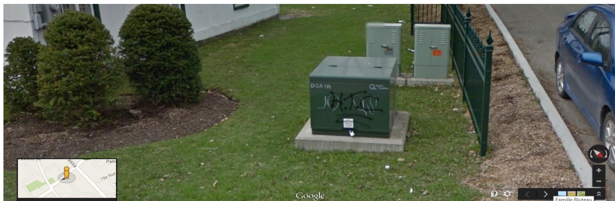
Vue des infrastructures électriques de biais avec la maison Pierre-Lefebvre
