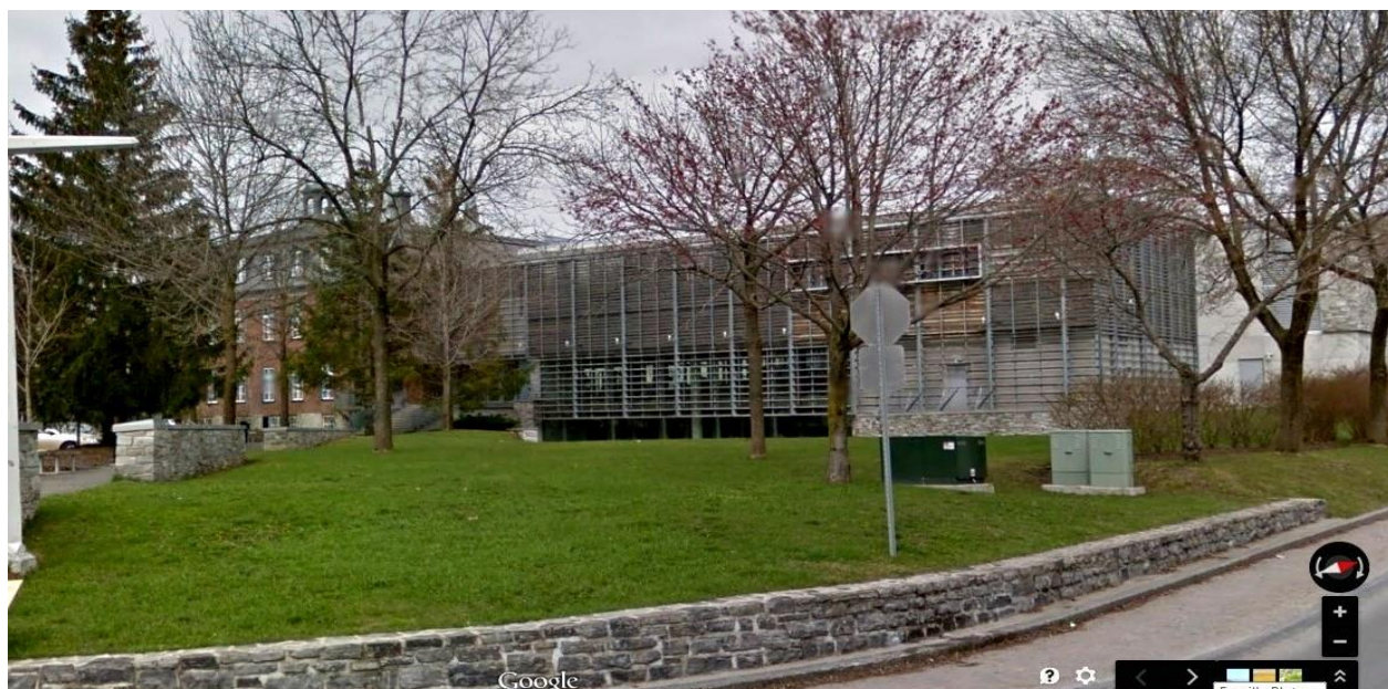
Vue des infrastructures électriques à l'arrière de la bibliothèque
